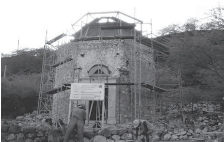
FIGURA 4. Proceso de rehabilitación de la capilla de Trindade, Isla de Santiago, Cabo Verde (Fotografía cortesía: A-RSF).
