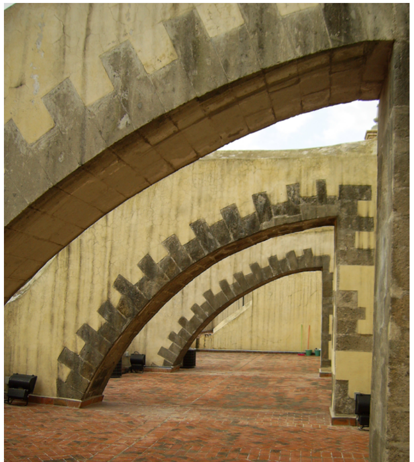
FIGURA 12. Contrafuertes en el muro poniente de la bóveda insertados en 1740, una mala decisión tomada por fray Juan de Dios de Rivera poco después de la muerte de Pedro de Arrieta (Fotografía: Ivan San Martín, abril de 2019).
